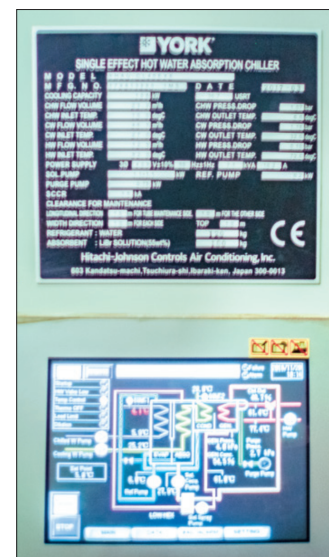
Obr. 14: Řídicí panel absorpčního chlazení firmy VS-top, s.r.o., v bramborárně Havlíčkova Borová zemědělská a.s.
